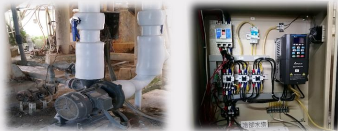
水泵汰換+變頻控制
