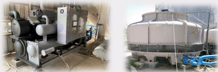
將傳統冰機更換為一級能效冰機
